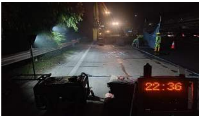
Gambar 1. Penampakan Jalan yang akan diperbaiki
